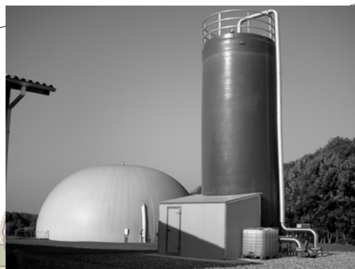
丹麥 LinkoGas 沼氣廠內沼氣儲存袋槽(左)及沼氣脫硫(右)設施外觀
