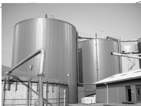
丹麥 Ribe 沼氣廠內厭氣發酵槽(中間)及糞泥等原料儲存槽(左)外觀
